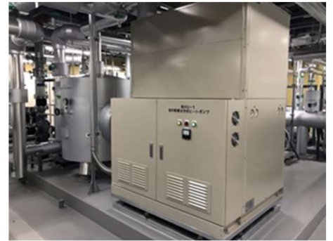
写真3 地中熱ヒートポンプ
