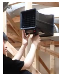
▲小屋裏ダンパー風量の計測
