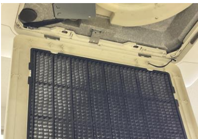
図 清掃されていないエアコンのフィルター
