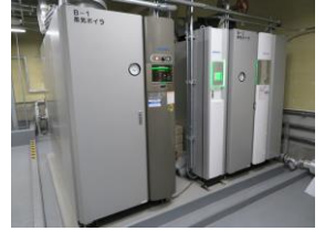
ボイラー (B-1, B-2)
