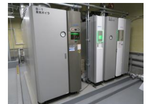
ボイラー (B-1,B-2)
