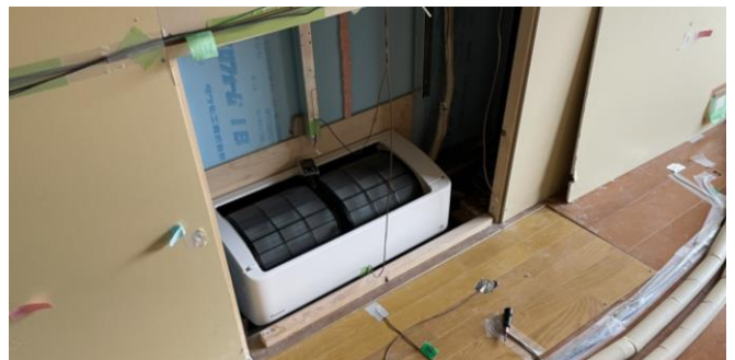
図 床下吹出用エアコン
