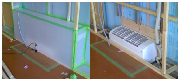
図 床下吹出用エアコン
